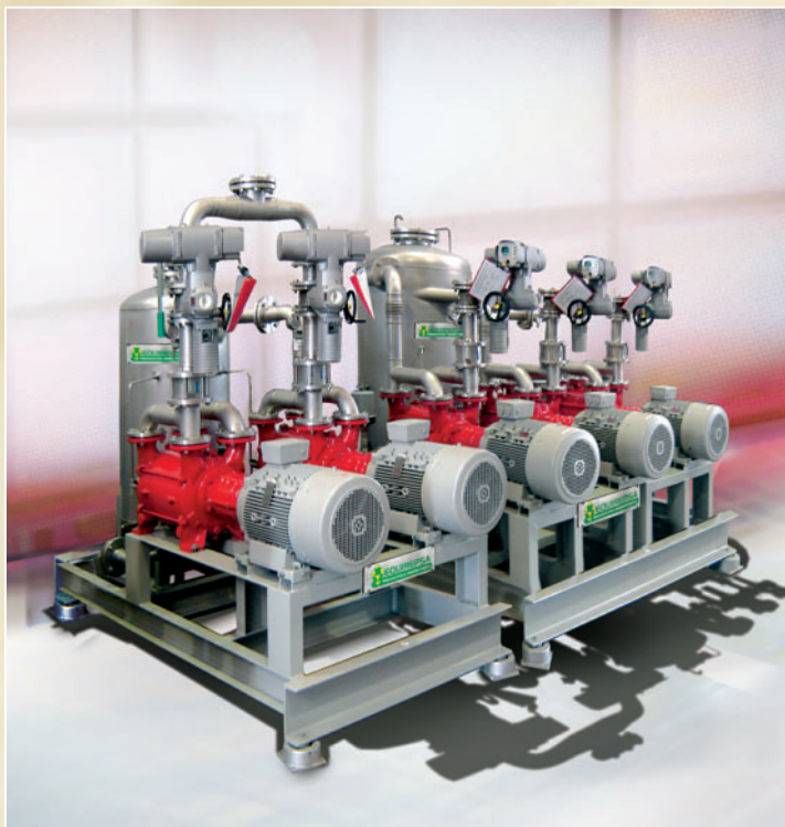
PRESION DE ASPIRACION: 213 TORR. CONDUCCION DEL AGUA DEL MAR UTILIZADA EN LA REFRIGERACION DEL CONDENSADOR
